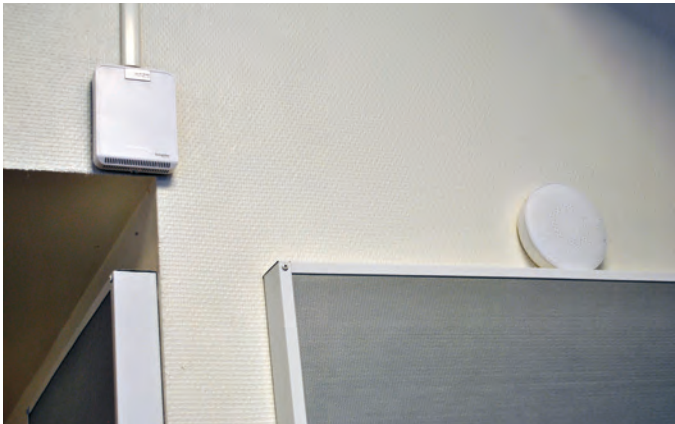
Det har blitt installert målere for CO 2 , temperatur og luftfuktighet i flere av klasserommene slik at driftslederen kan følge med og gjøre justeringer på det tekniske anlegget.
