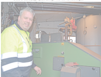
Dette er selve flisfyrkjelen som gir 700 kw. varmeenergi...
